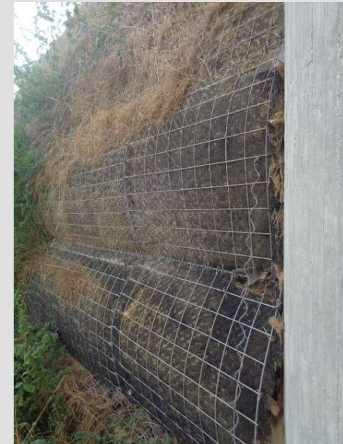
Erdverbundkonstruktion stark ausgebaucht
