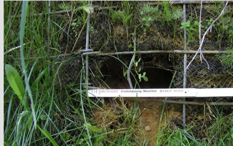
Drähte verbogen; teils abgerissen
